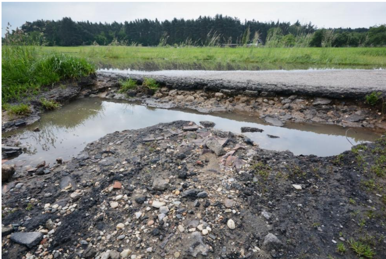
Poškozený mostek do pole u cesty k Výrovce
